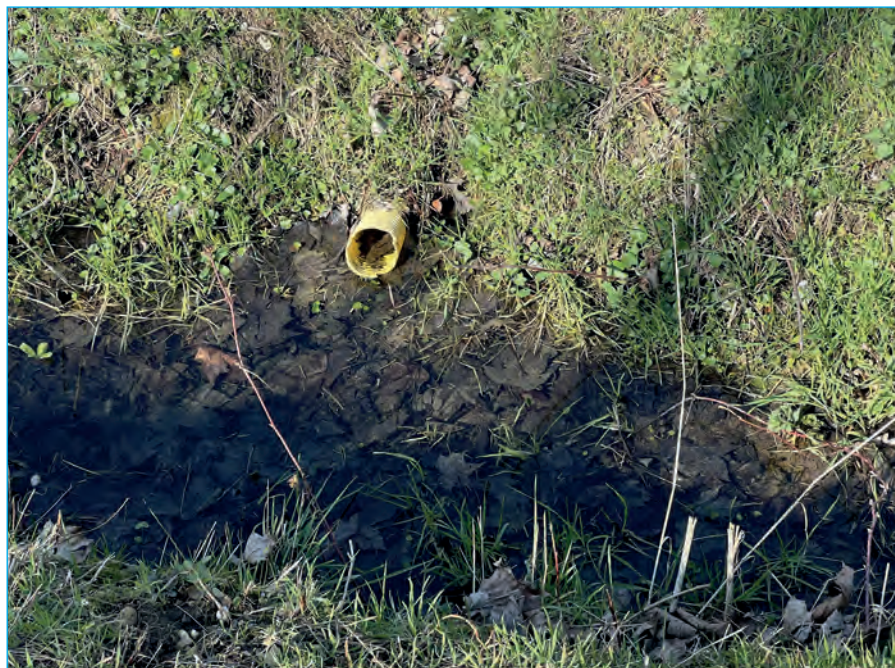
Abb. 12: Drainrohr an Grabenböschung ohne Wasser (Belmer Weg)
